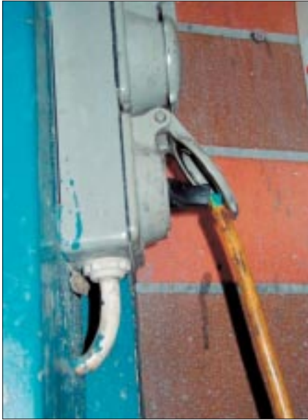
Abb. 7. Elektrisierungsgefahr durch fehlerhafte technische Einrichtungen.
